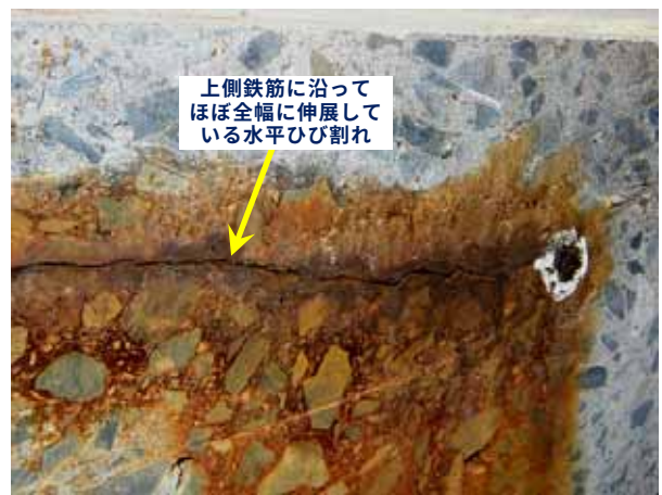
図-13 水平ひび割れの伸展状況
