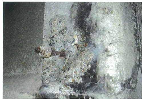
写真-1 横締め PC 鋼材の破断事例
