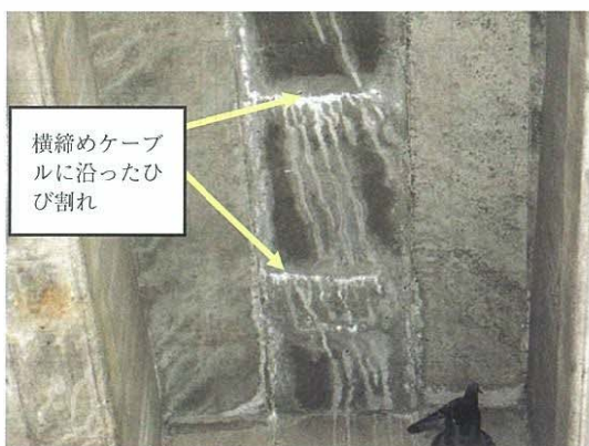
写真-4 間詰め床版下面に発生したひび割れ
