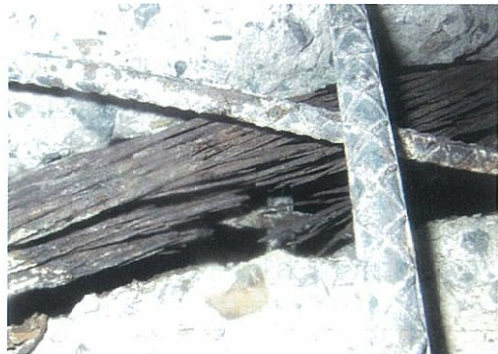
写真-2 主ケーブル PC 鋼材の破断事例
