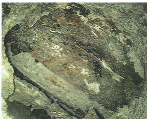
写真-7 グラウト充てんが不十分でPC 鋼材が腐食している状況
