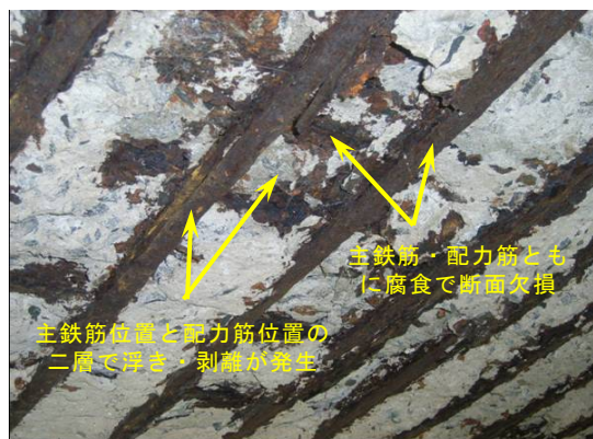
写真-1 二層化した浮き・剥離
