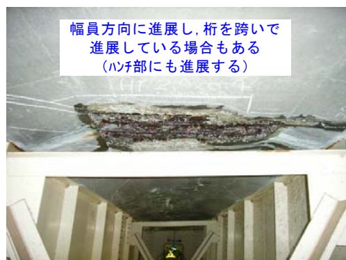
写真-3 タイプ2の浮き・剥離
