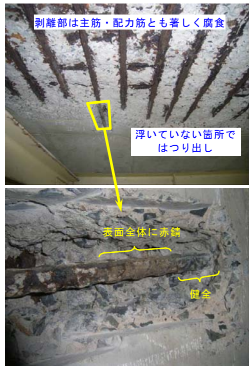
写真-4 剥離部周辺の腐食状況（A 橋）
