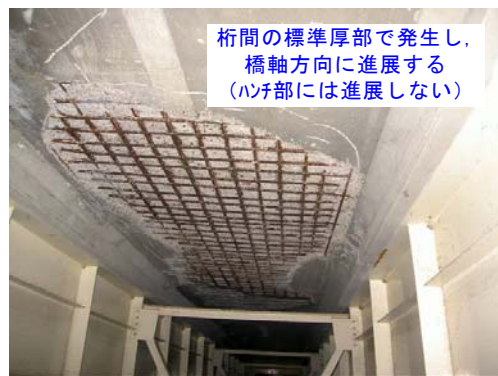
写真-2 タイプ1の浮き・剥離
